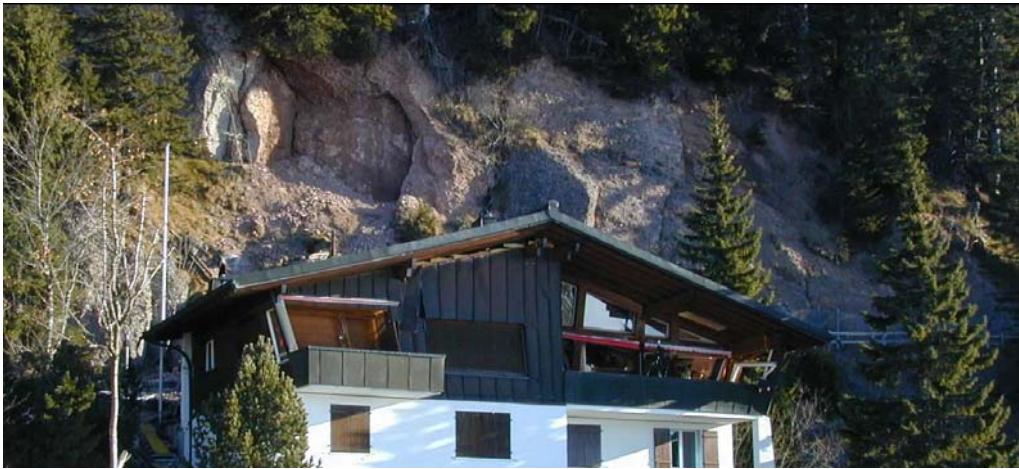
Abbildung 5.32: Frontalansicht des beschädigten Hauses auf Rigi-Kaltbad. Der gesamte Dachstock wurde stark beschädigt. Im Hintergrund gut zu sehen der wenig oberhalb liegende Ausbruch im Molassegestein. Foto: K. Louis.
