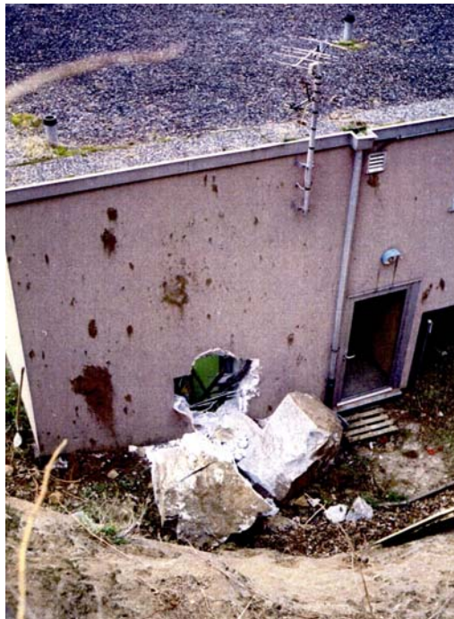
Abbildung 5.30: Der 6 Tonnen schwere Block der ins Hallenbad von Göschenen einschlug. Foto: U. Thali
